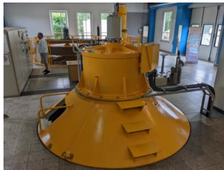
Fotos links: Gewaltige Turbinen werden von der Wasserkraft in Oberwallenstadt angetrieben.
